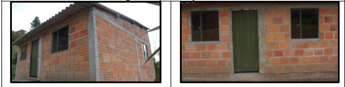
Imagen 24. puertas y ventanas
