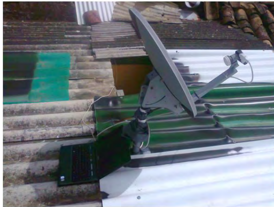
Sistema apuntando al sol
