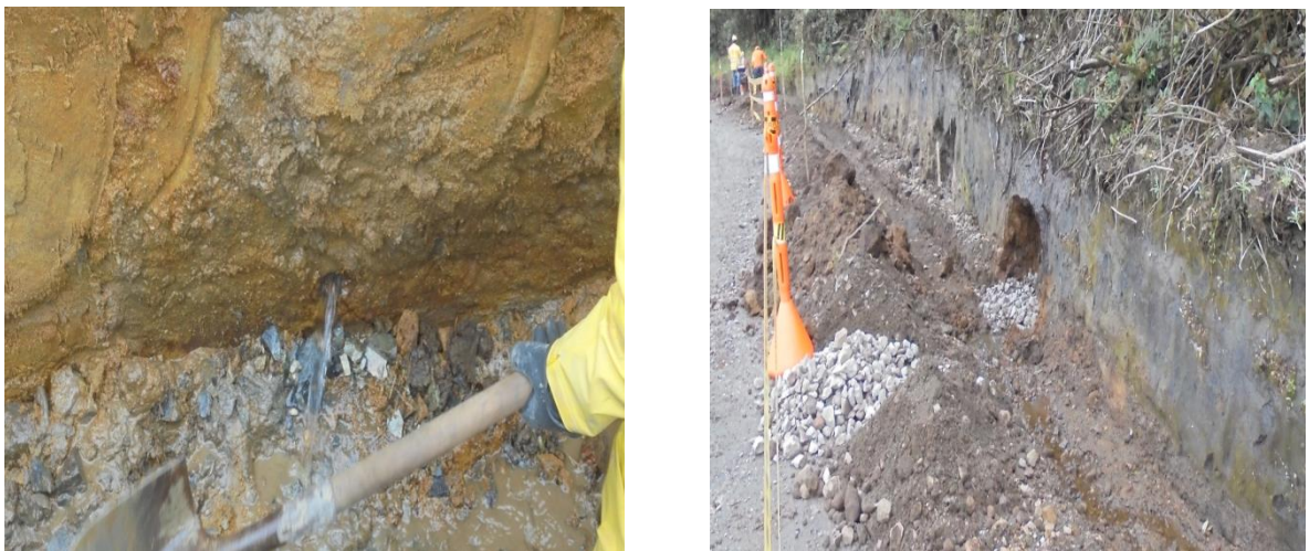
Figura 3.4. Manejo de aguas subterráneas.
